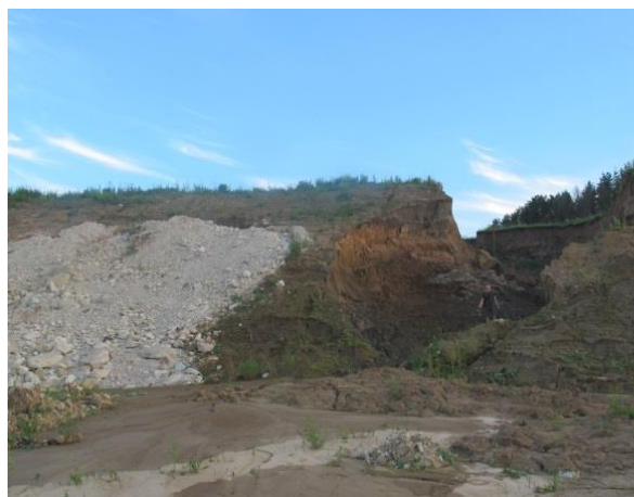
Рис. 4. Оползень и заболачивание на территории Афанасьевского карьера (фото А.И. Подлесных).
